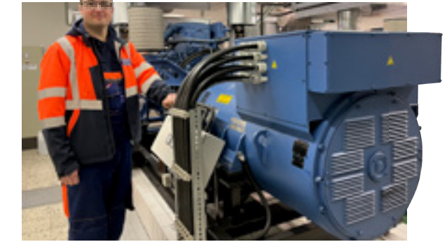
▲ Das gibt Sicherheit. Jan Beckmann in der Halle mit den beiden leistungsstarken Notstromaggregaten, die bei Bedarf anspringen. Foto: SPREE-PR/Galda
