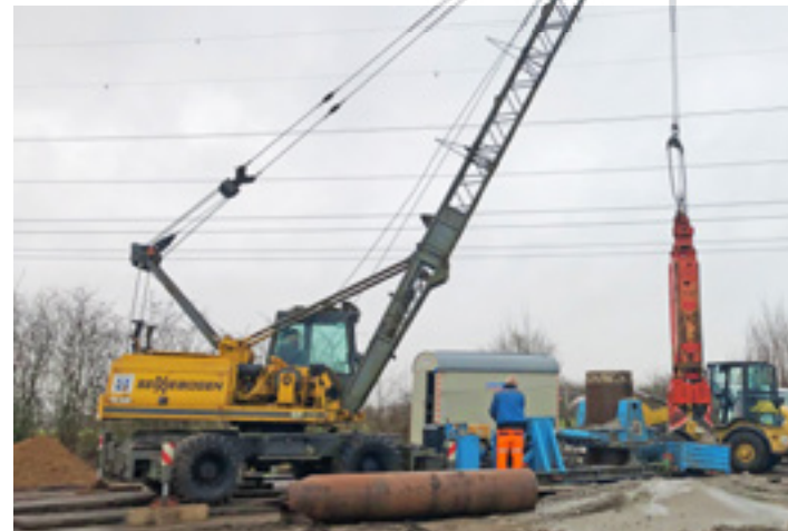
▲ Wenig zu sehen, denn das meiste passiert unter der Erde. Schwere Technik ist beim Brunnenbau nötig. Foto: WVN
